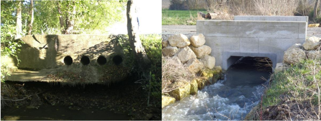
Photo 12 : Exemple de buse remplacée par un dalot à fond naturel
