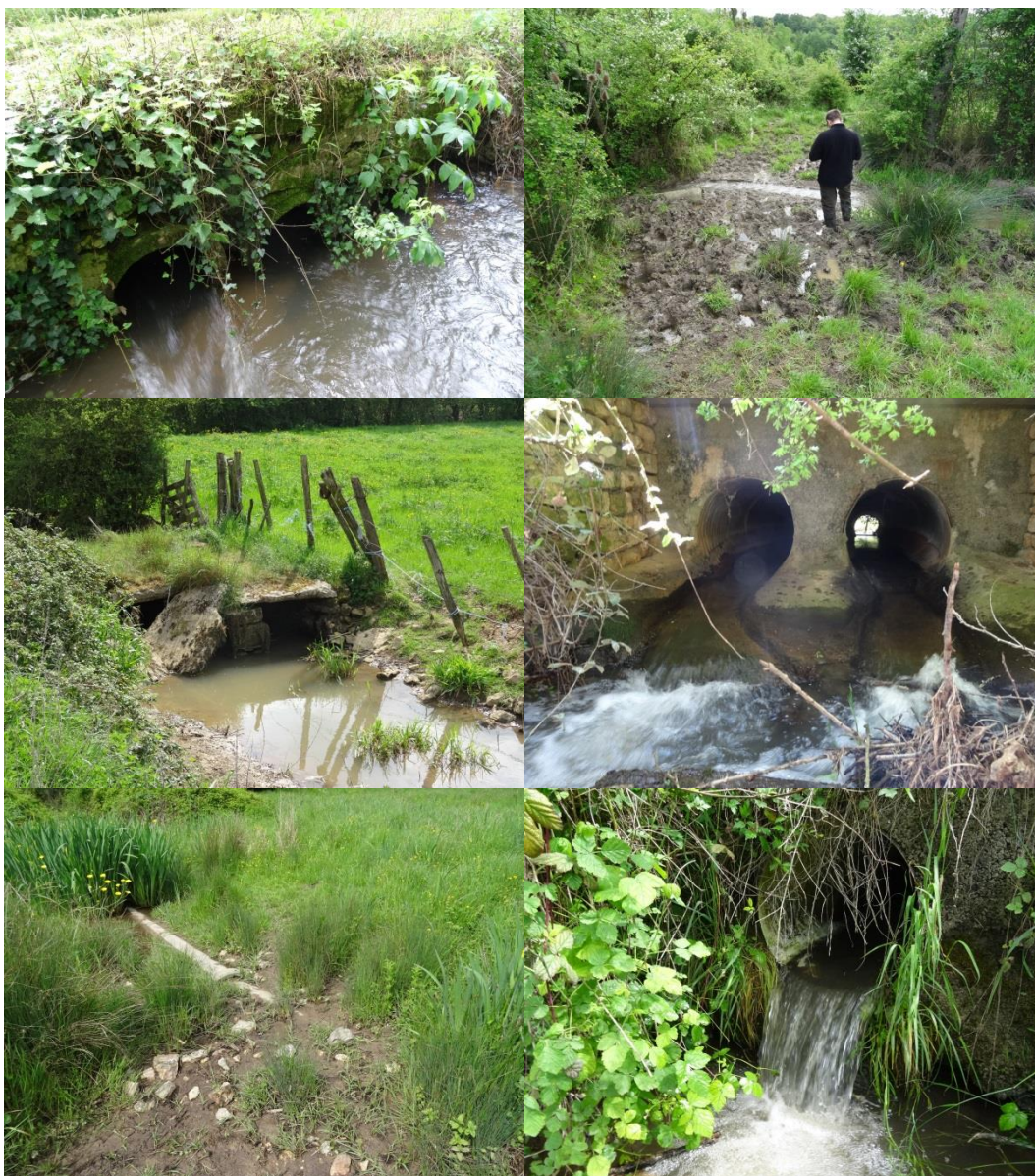
Photo 14 : Exemples d'ouvrages de franchissement à remplacer
